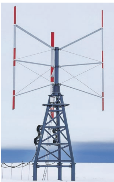
Die im Außenbereich installierte Bachmann-Technik ist für einen dauerhaften Betrieb bei Temperaturen von -30° bis +60°C ausgelegt.
